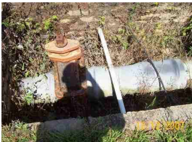
Fotografía 3 Válvula de control de la red de aducción de PVC.
